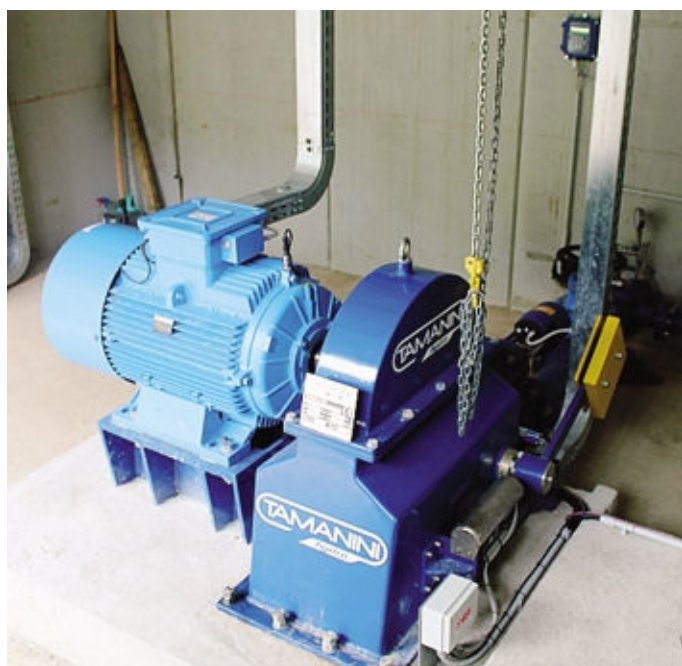
La centralina elettrica è attiva da due mesi a Isola di Fondra
